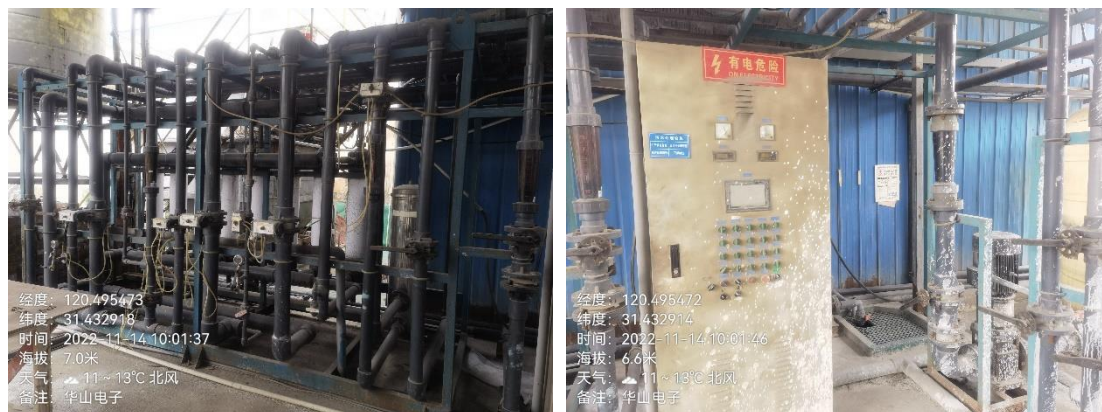
图4.1-3 生产废水管道（地上）
