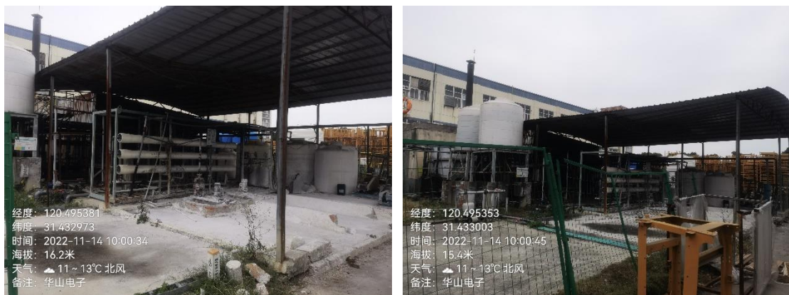
图4.1-1污水站收集调节储罐
