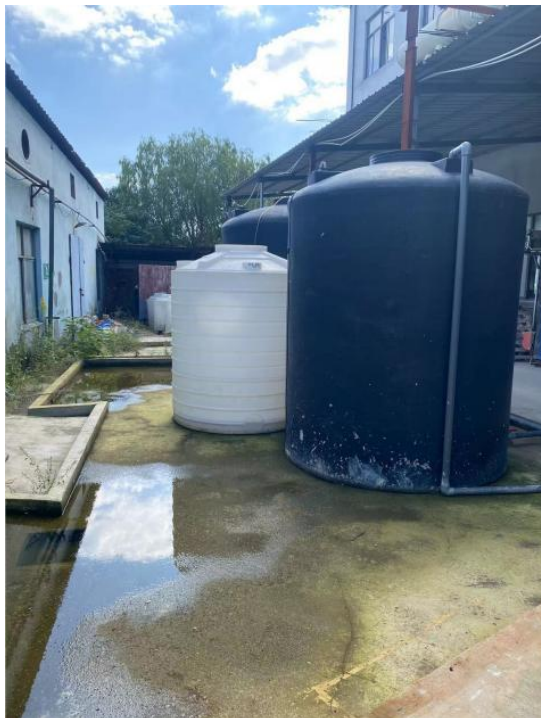
图4.1-1污水站收集调节储罐
