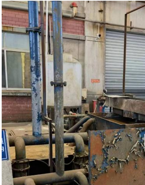
图5.1-6 生产废水管道（地上）
