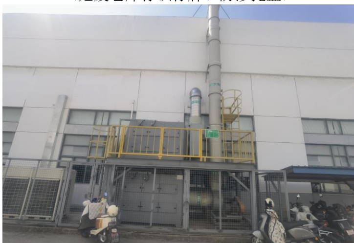
(FQ-902401 排气筒、废气处理设施)
