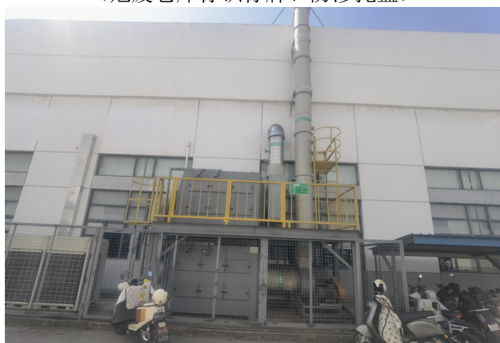
(1#排气筒、废气处理设施)
